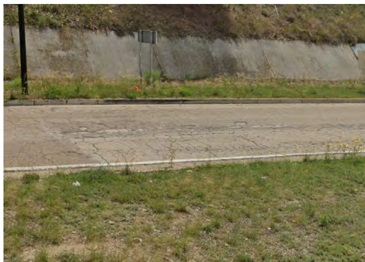
Estado actual pavimento asfáltico calle A
