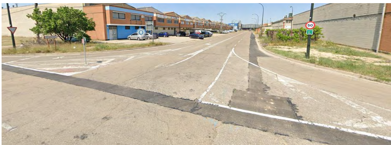
Estado cruce calle D con calle L
